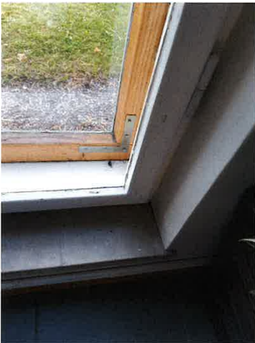
Ikkunoiden F101, F102, F103 ja F104 ikkunapenkki on Harmaankirjavaa keraamista laattaa. Tässä F102.
